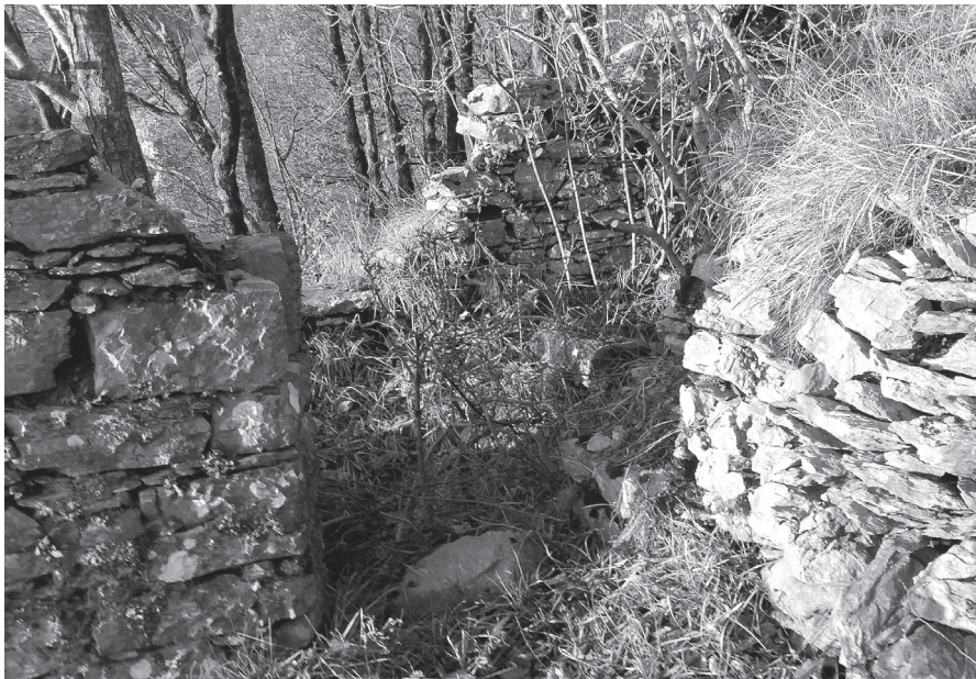
Fig. 62. Una foto laterale del rudere in cui si intravede, al centro, la zona con la fossa in cui era probabilmente incassato il peso per l'ancoraggio del cavo.
