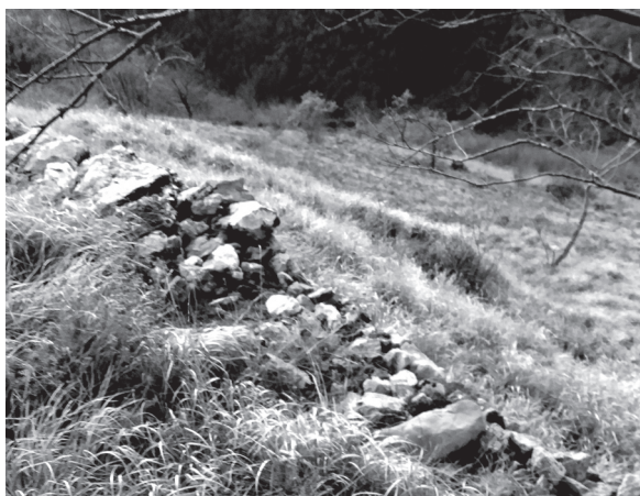
Fig. 69. Un'immagine del sentiero percorso dai turisti diretti all'Alto Matanna per raggiungere la piazzola di stazionamento della vettura. Si noti il muro a secco, ora parzialmente crollato, eretto verso la valle per evitare smottamenti del terreno.
