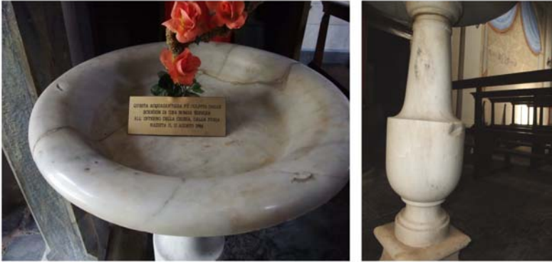
Fig. 55. Due dettagli dell'acquasantiera della chiesa di Sant'Anna di Stazzema che mostrano ancora i segni degli effetti della bomba fatta scoppiare all'interno dell'edificio. Il pavimento accanto all'acquasantiera reca anch'esso le tracce dello scoppio della bomba. Questo il testo della scritta collocata nel bacino dell'acquasantiera: "QUESTA ACQUASANTIERA FU COLPITA DALLE SCHEGGE DI UNA BOMBA ESPLOSA ALL'INTERNO DELLA CHIESA, DALLA FURIA NAZISTA IL 12 AGOSTO 1944". I nazifascisti utilizzarono le panche e i mobili della chiesa per bruciare i corpi delle vittime trucidate nella piazza, e distrussero l'antico organo. La profanazione delle chiese ricorre nelle stragi nazifasciste perpetrate in Italia tra il 1944 e il 1945, ed è in parte da collegare agli aspetti paganeggianti della mistica nazista e fascista (che ebbe in Italia tra i suoi esponenti principali il filosofo Julius Evola).
